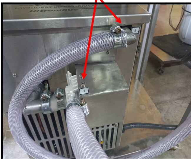
Conexões das mangueiras
